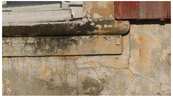
Figure 1: Constat de fissures sur façade
